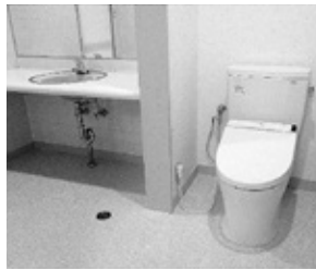
トイレ・洗面台
